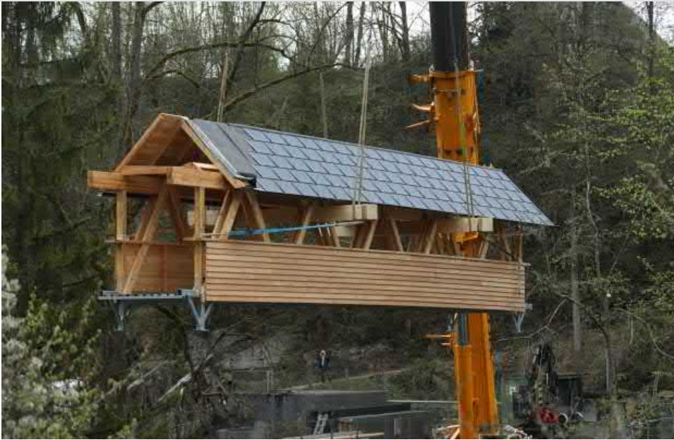
Am 15. April 2018 brachten Profis den neuen Traunfallsteg mit Hilfe eines Schwerlastkranes spektakulär in Position.
